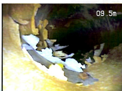
【内面防食塗装劣化(シールドの剥離)】
