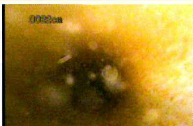
洗管前)赤水で濁っている
